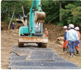
災害復旧現場
